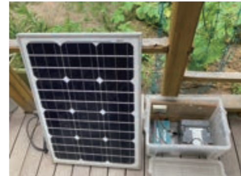
大雨で壊れたオフグリッドソーラー
