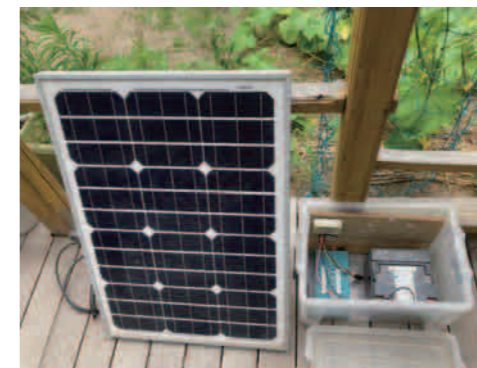
大雨で壊れたオフグリッドソーラー
